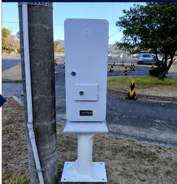
交換後（新型制御機）
